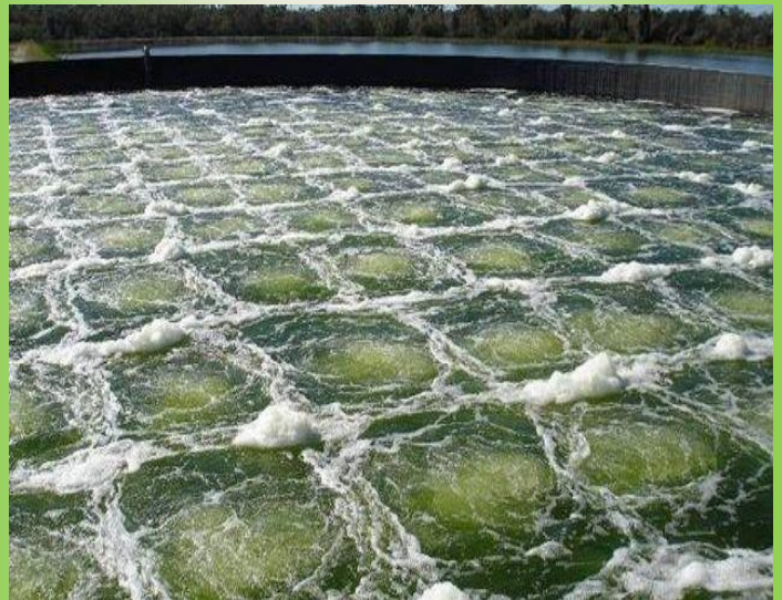
Bể sục khí
